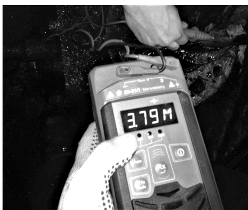
Рис. 4. Замер изоляции цепи «НКТ — насос — колонна штанг» на скв. 68А
