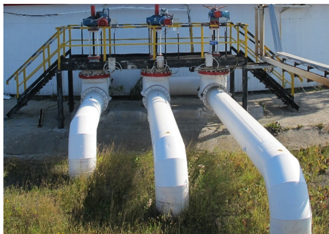
Рис. 1. Узел приема и раздачи нефти РВСП-20000
