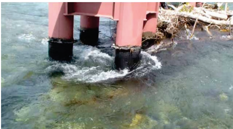
Рис. 1. Размыв опор перехода через реку Правый Кихчик
