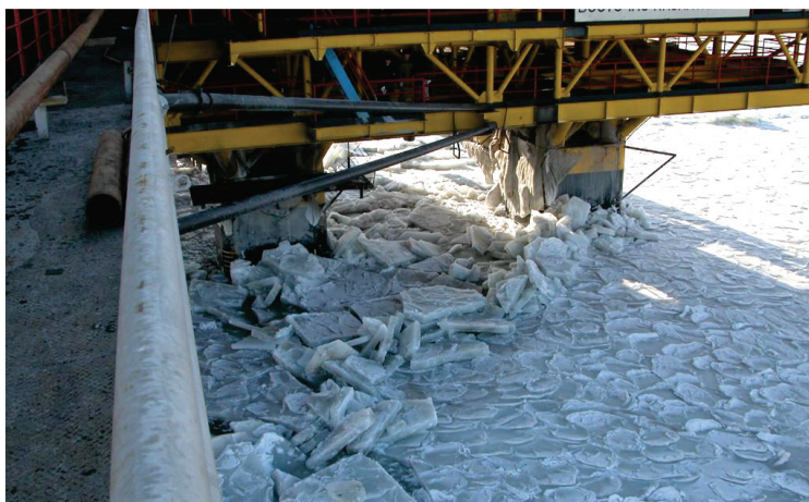
Рис. 2. Ледовая обстановка и взаимодействие опорных стоек МСП в Азовском море на газовом месторождении
